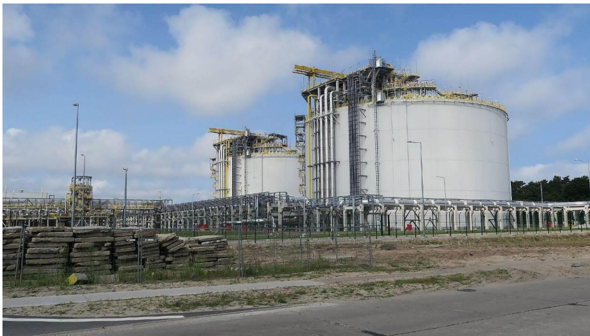
Ryc. 16. Zbiorniki gazu – terminal LNG
