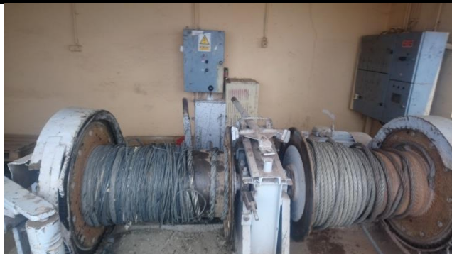
Fot. 2. Winda wyciągowa
