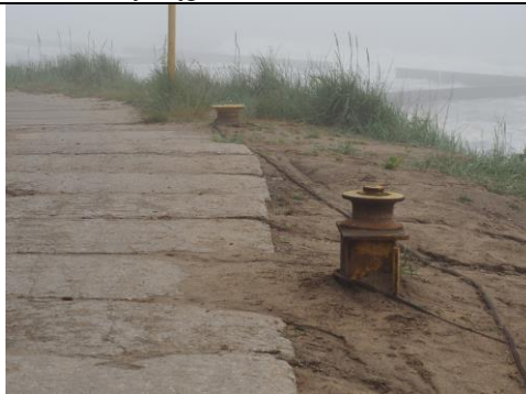
Fot. 4. Kabestan – widoczna korozja powierzchniowa
