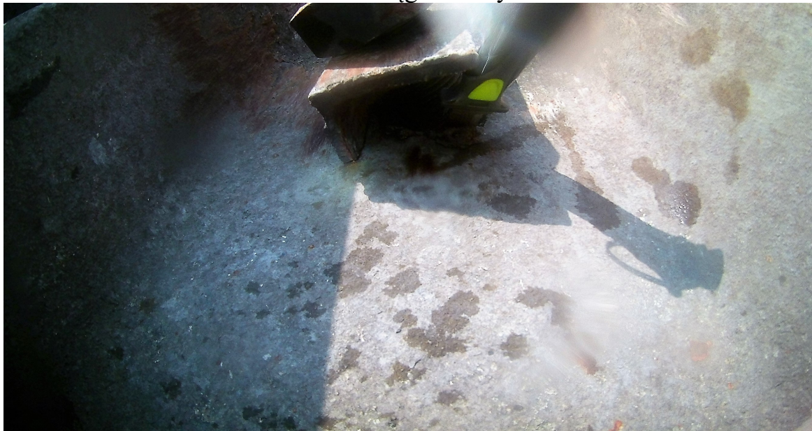
Zdjęcie nr 2 - widok kolektora, wystaje około 25 cm ze ścianki.
